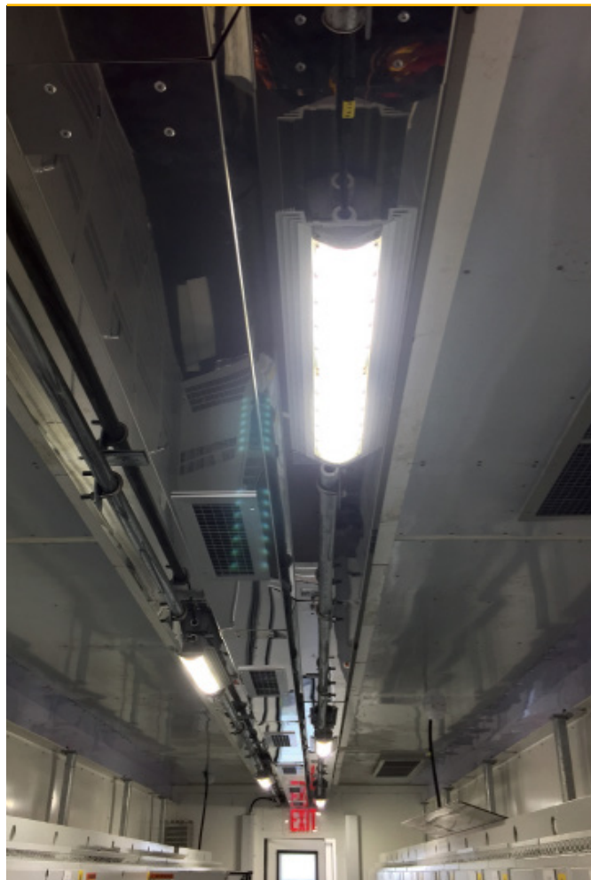
Luminarias HDL2 en una sala de controles eléctricos
