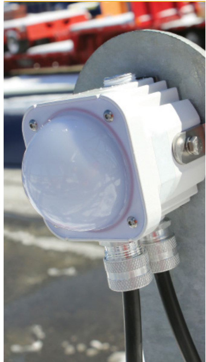
Una Cube-Light-Light montada en una grúa STS
